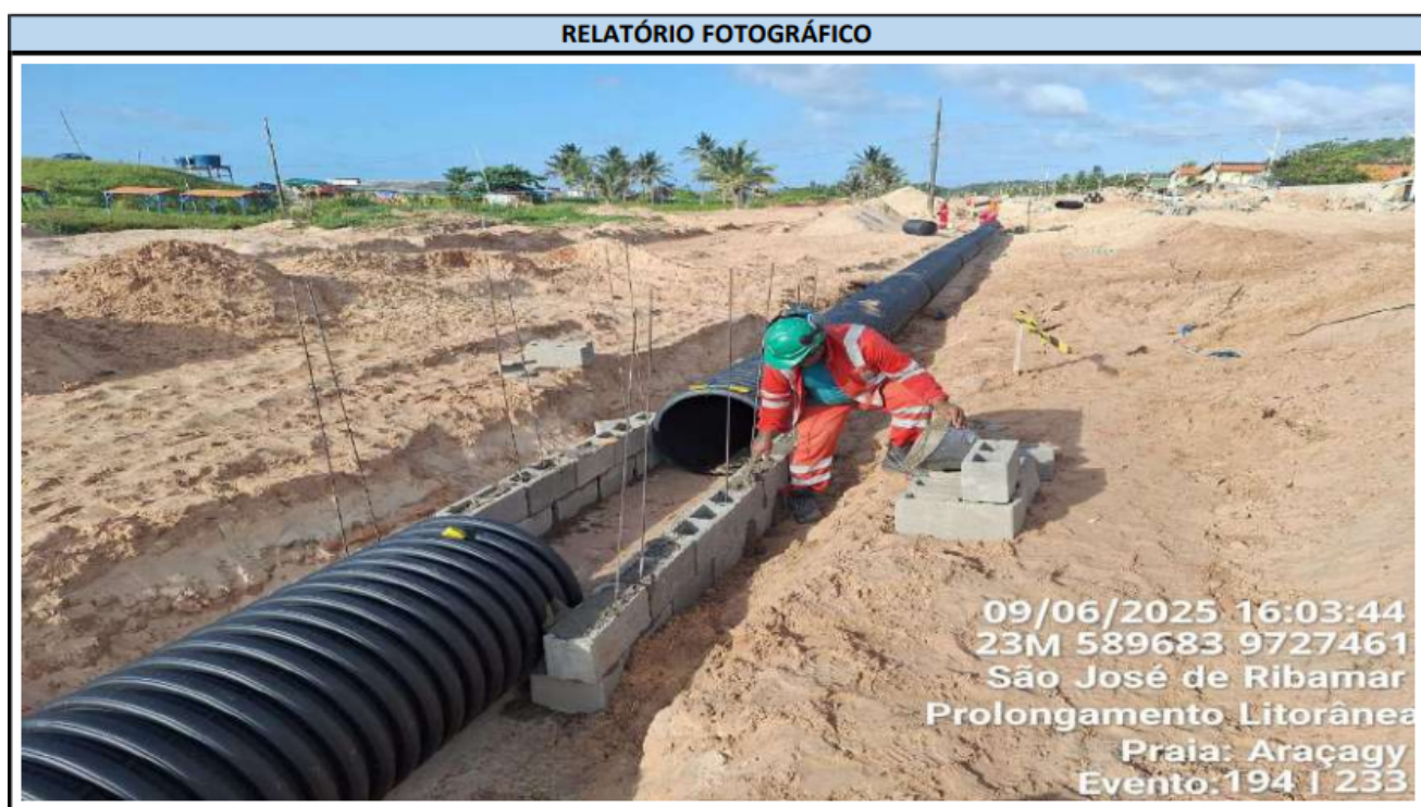
FOTO 21 - FRENTE ARAÇAGY - Corpo de Bueiro + BLCD
